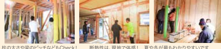
柱の太さや梁のピッチなどもCheck! 断熱性は、現地で体感! 夏や冬が最もわかりやすいです
